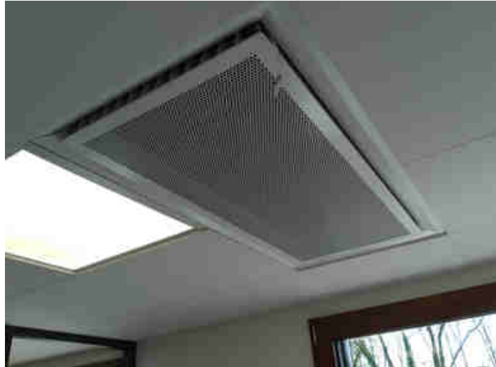
Figure 11 : Poutre climatique sur le bâtiment 3 - bureaux
